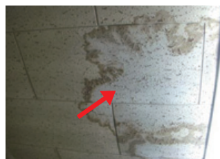
外部及び内部の雨染み
