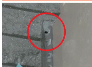
シーリング材の割れ、施工不備
