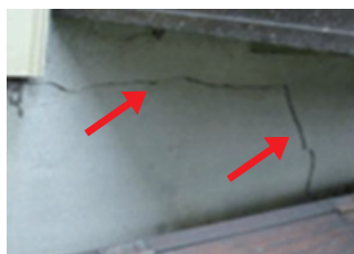
基礎のひび割れ
